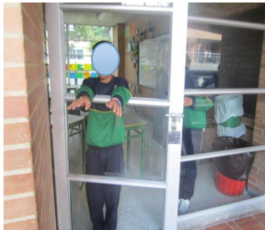
Figura 26. Estudiante que evidencia la falta de vidrio en su salón por causa de un golpe cometido por otros estudiantes.
