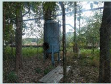
Filtro en abandono, vereda La Chamba, 2024.
