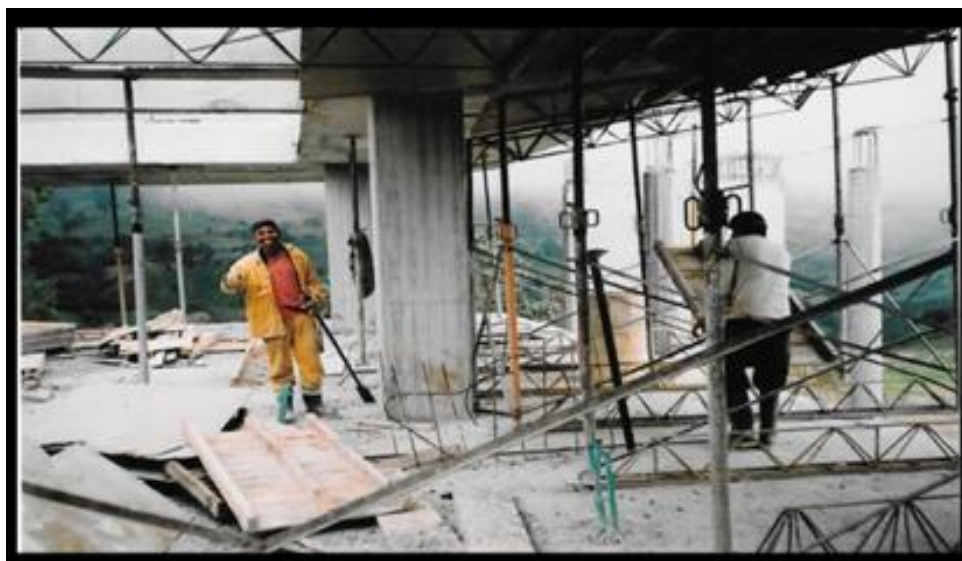
Fotografía 3. Avance en la construcción de las instalaciones nuevas del colegio. Archivo personal del profesor Joaquín.
