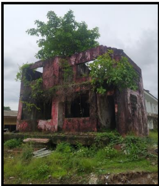
Figura 3. Construcciones en ruina
