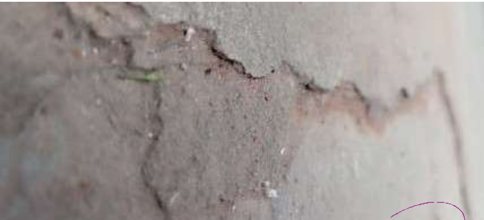
Foto 3. La grieta se hace visible. Fotografía de la autora (2023).
