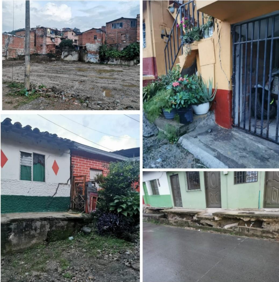
Figura 4. Grietas en las calles y viviendas de Amagá, evidenciando los riesgos inminentes de remoción de masas
