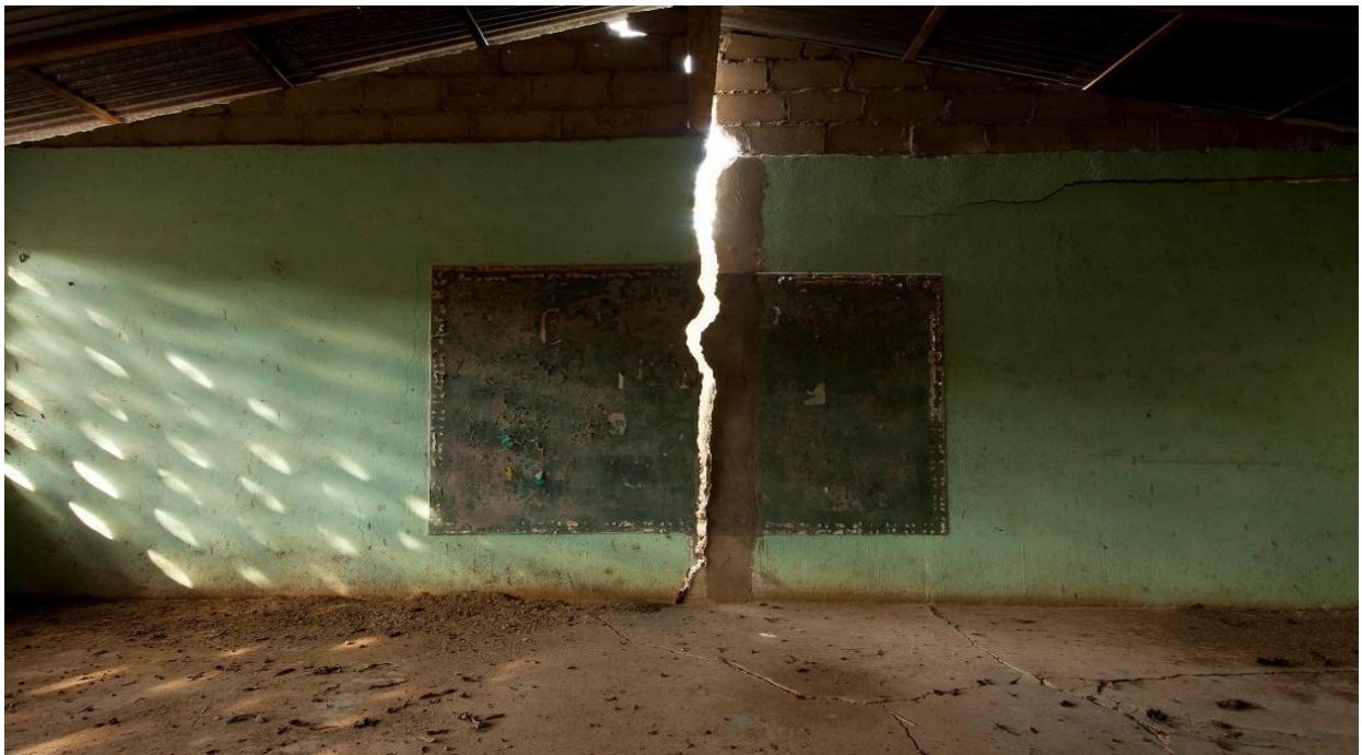
Imagen 6. Silencio con grieta en Escuela Las Palmas. En Silencios , por J. M. Echeverría, 2010, https://jmechavarria.com/es/work/silencios/ .
