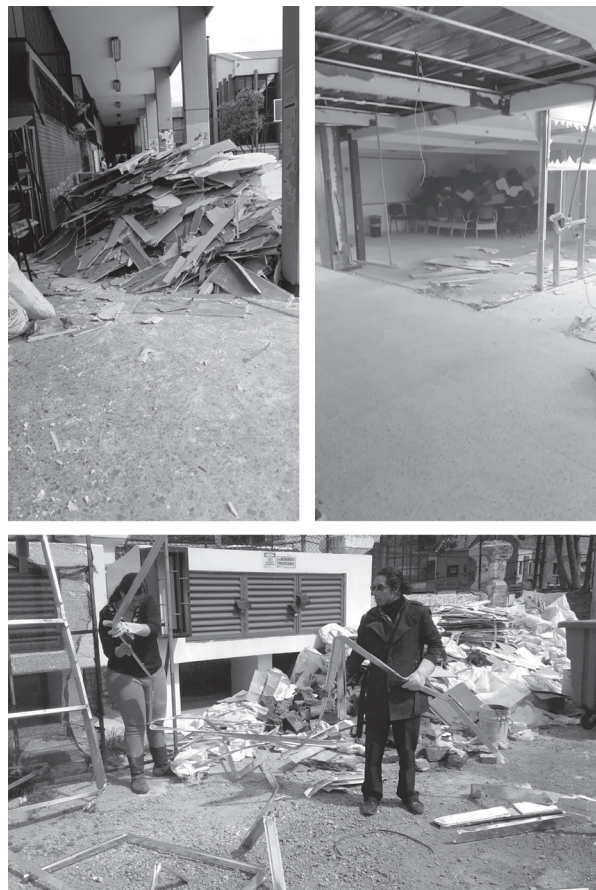
Figura 5.19. Imágenes días después de lo acaecido el 6 de marzo del 2018 en el edificio C
