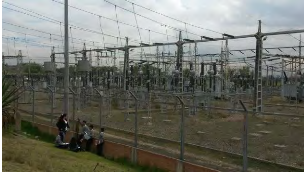
Contaminación auditiva – Fuente: Planta eléctrica
