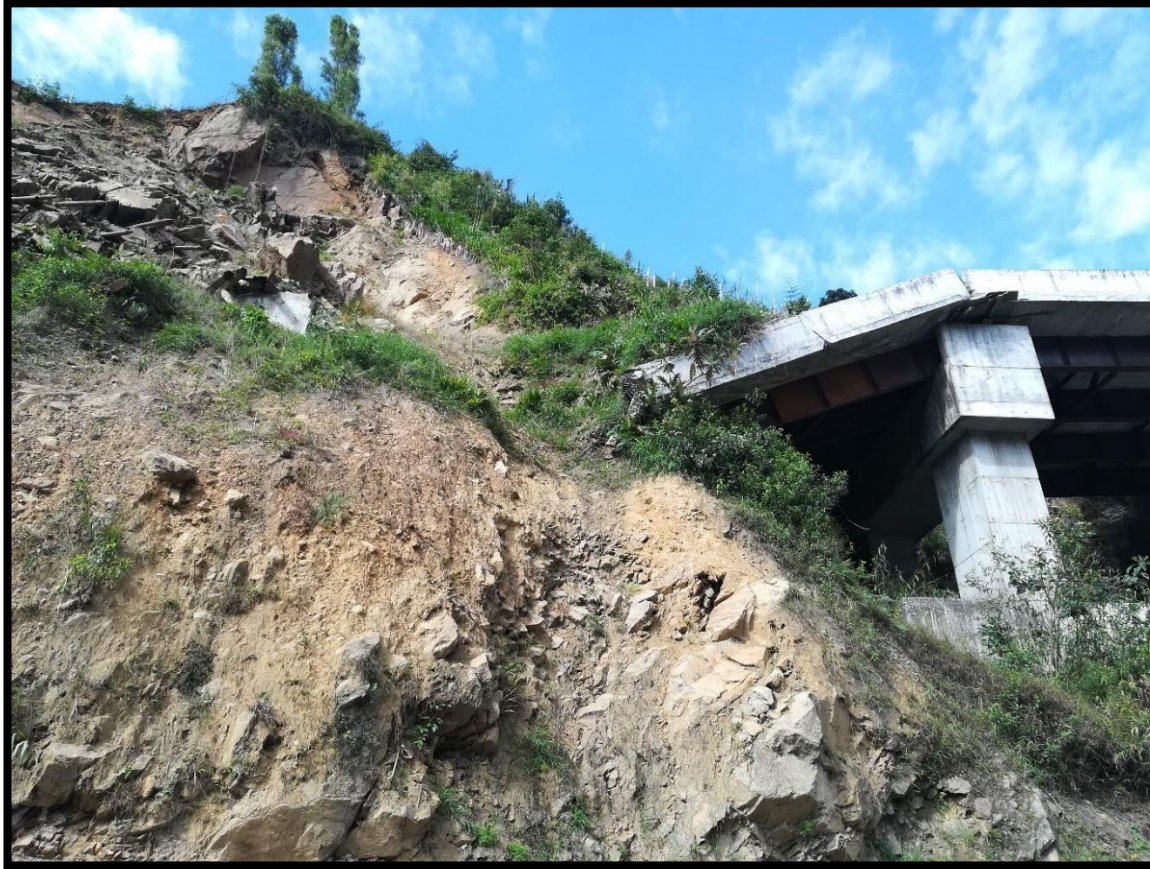
Imagen 15: fuente propia tras el abandono de la obra se ha deteriorado ampliamente lo ya construido.
