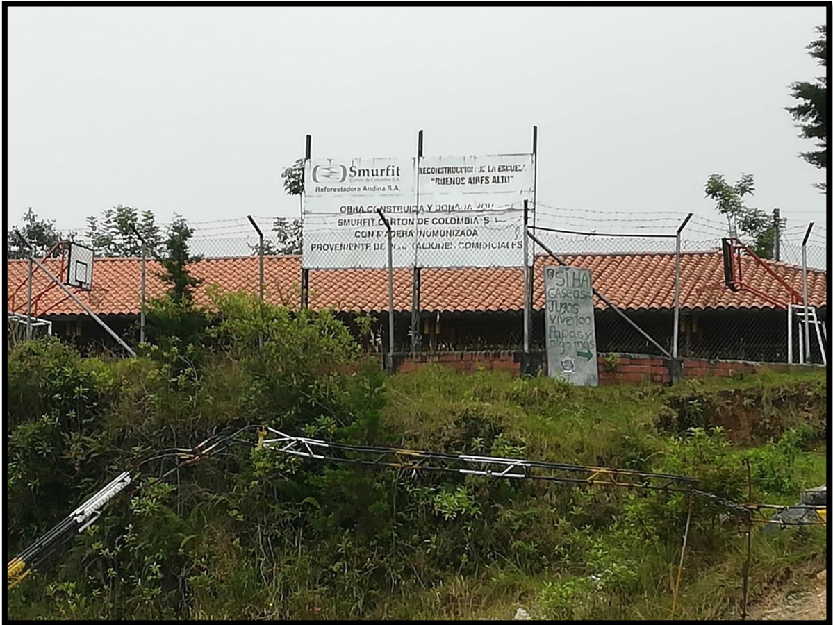
imagen 19 escuela donada por Smurfit Kappa en el alto de la línea y su posterior deterioro Fuente: elaboración propia
