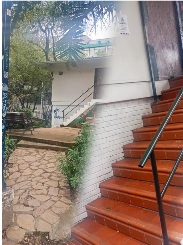
Casita de biología; escaleras sin señalética
