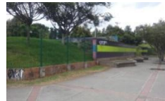
Vandalismo Foto N°81
