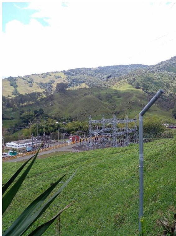
Figura 8. Torre de subestación energética de Manizales (CHECH)
