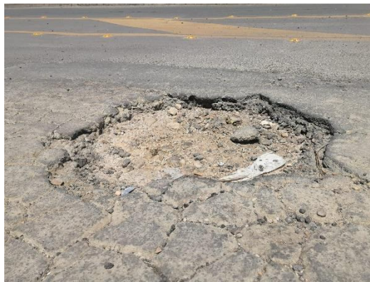
Ilustración 18. Irregularidad hueco peligroso.
