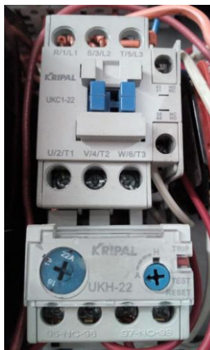
Figura 38: Contactor. Fuente propia
