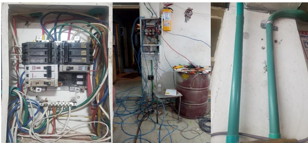
Figura 31: Conexiones eléctricas, caja de tacos, tablero y cometida. Fuente propia.
