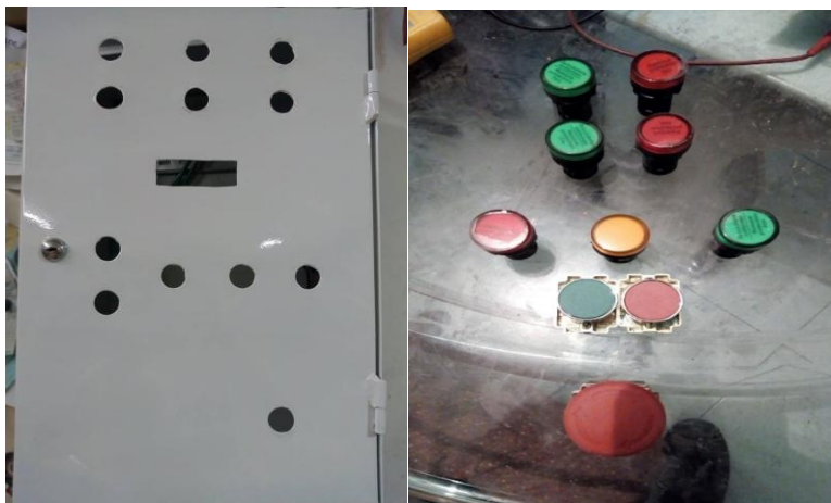
Figura 28: Tablero de control eléctrico en construcción. Fuente propia.
