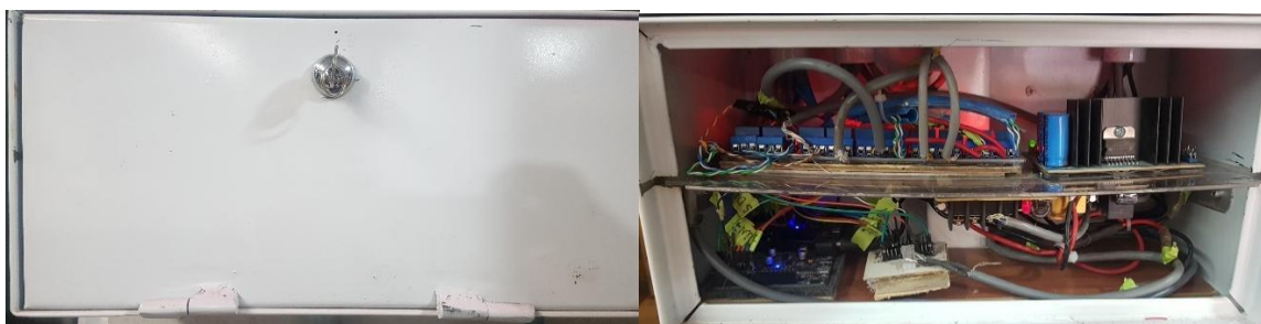
Figura 29: Tablero de control. Fuente propia
