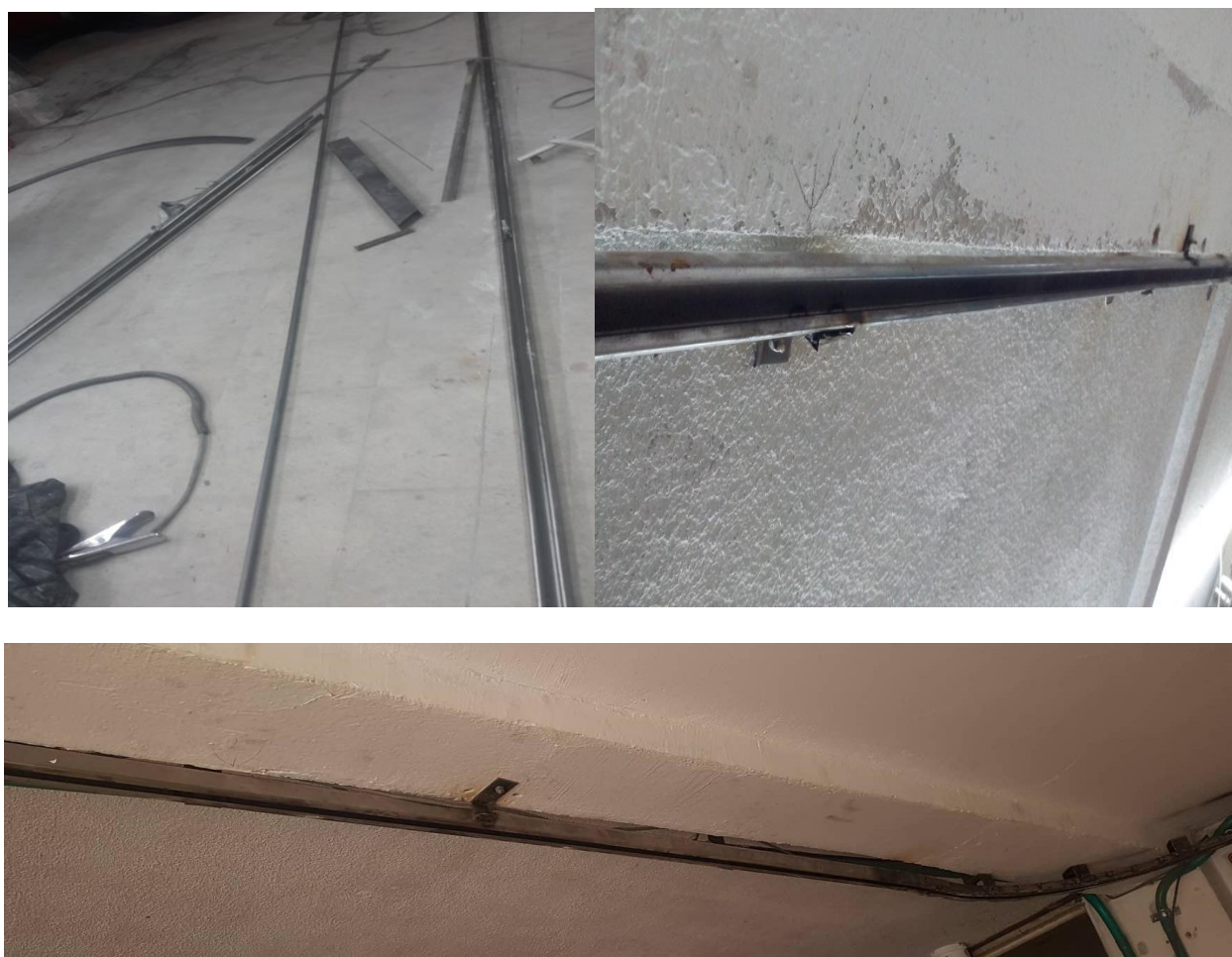
Figura 20: Anclaje al techo sistema corredizo. Fuente propia
