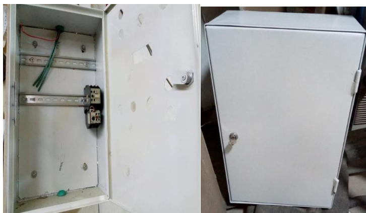
Figura 27: Caja de control eléctrica pintada. Fuente propia
