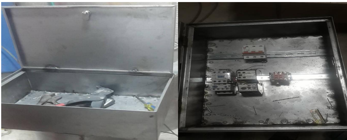
Figura 26: Caja de control eléctrico en obra negra. Fuente propia
