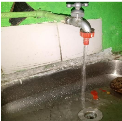
Imagen 6. Purga del grifo en el predio el Tesoro. Tomado por Pinzón, R. (2020).
