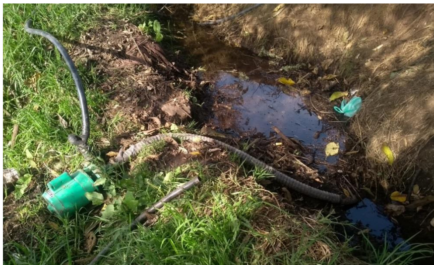
[Fotografía de autores] Unidad de bombeo.
