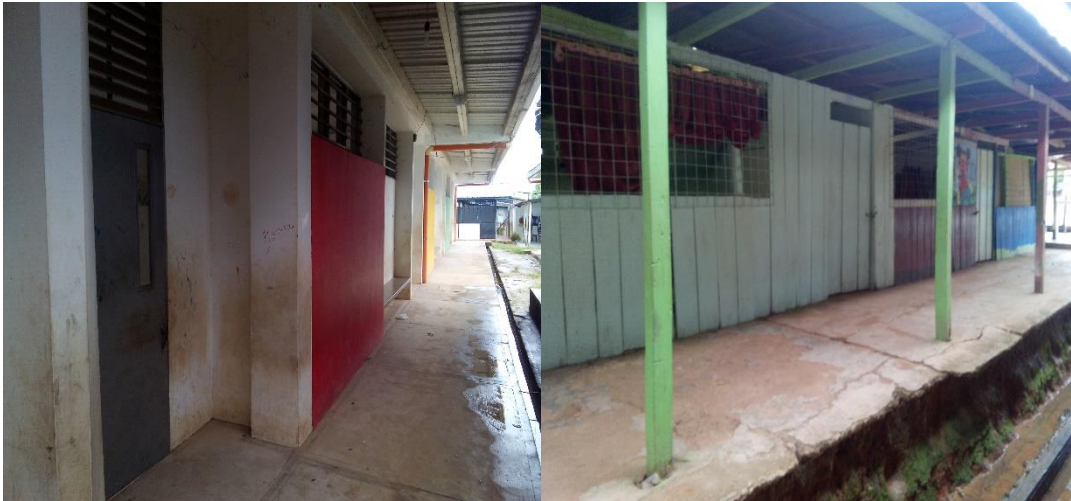
Ilustración 10 Aulas en la misma escuela. Las de la izquierda son salones construidos en concreto algunos permanecen vacíos. A la derecha salones en madera y gastad ay con humedad. Pese a eso algunos profesores prefieren usar esas aulas.
