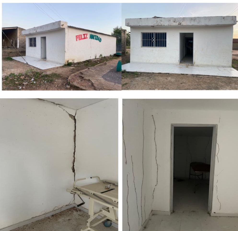
Imagen 7 Puesto de salud en riesgo de colapsar
