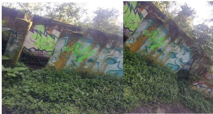
Construcciones ilegales dentro del humedal PEDH La Conejera como resguardo de habitantes de calle. Incrementa procesos de inseguridad y actividades de microtráfico. Elaboración propia.
