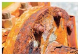
[11] La corrosión presenta destrucción o deterioro continuo de un material a través del tiempo, debido a una reacción química o electroquímica con el ambiente o con el microambiente.
