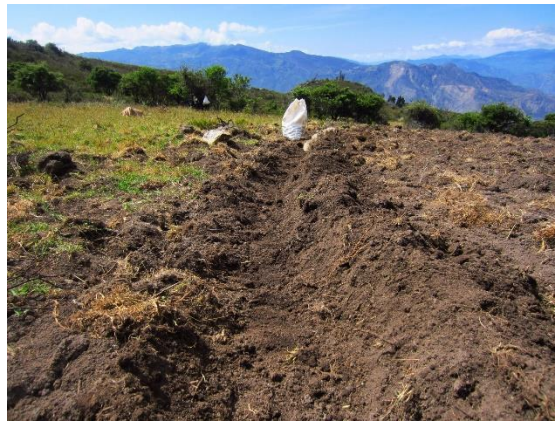
Figura 44. Toma de drenaje para el agua.2017
