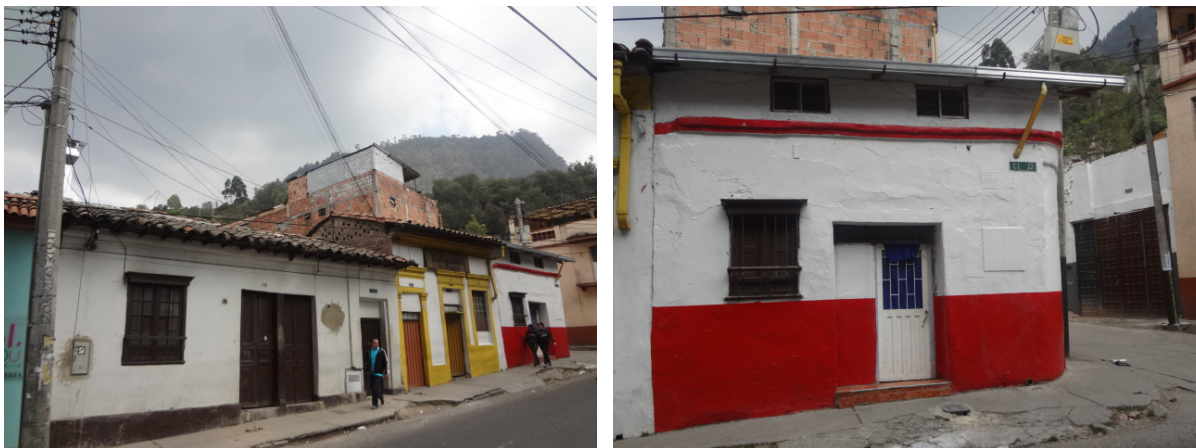
Figura 27. Fotografías casas deterioradas barrio Las Aguas.
