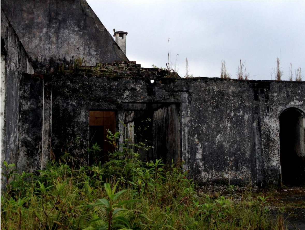
Foto # 4. Etna Castaño Giraldo. Casa Abandonada. Autopista del Café- Quindío. Junio de 2013.
