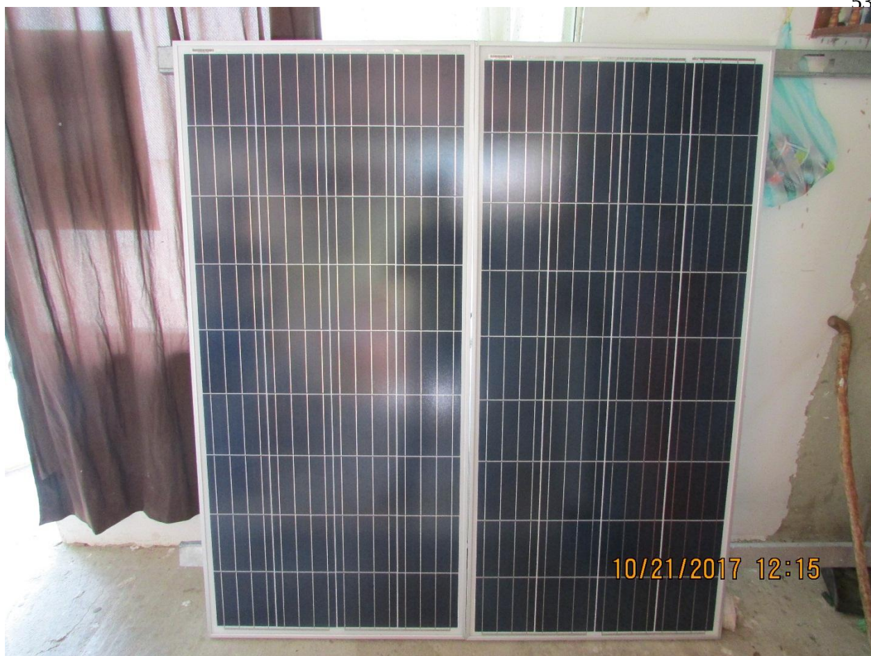
Figura 38. Paneles Solares conectados en paralelo
