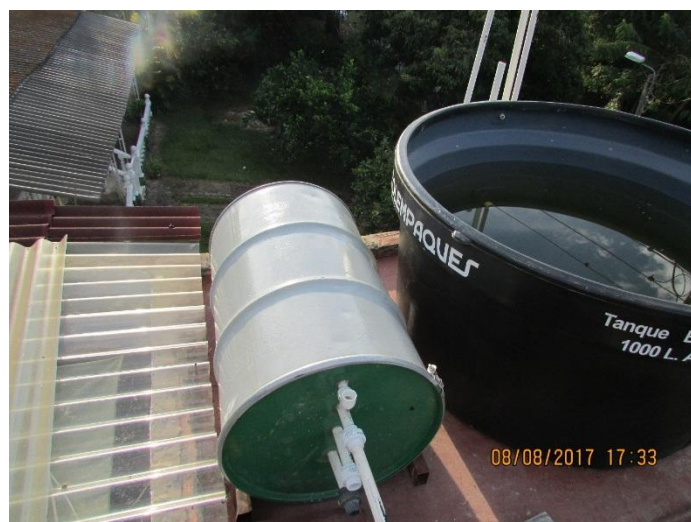
Figura 32. Instalación Termo tanque
