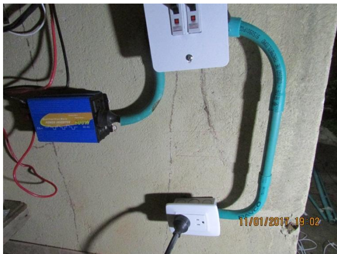
Figura 47. Instalación final fotovoltaica
