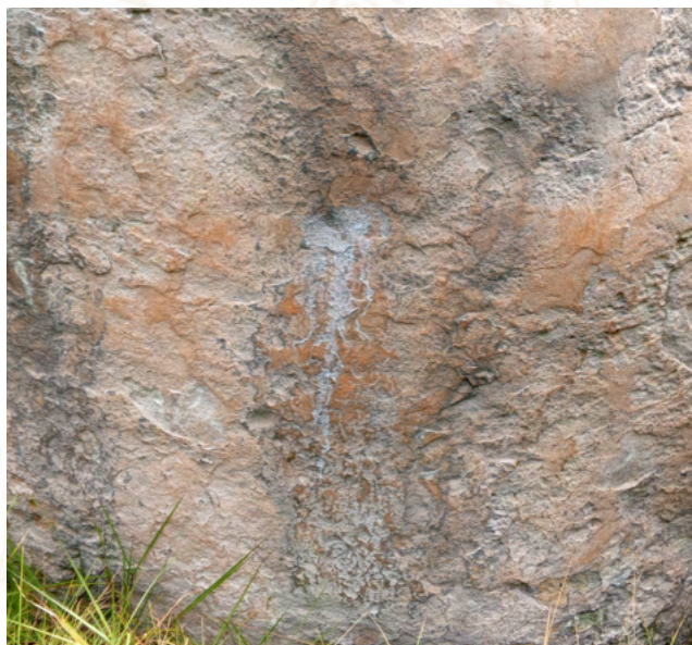
Afectación por Velos Salinos.
