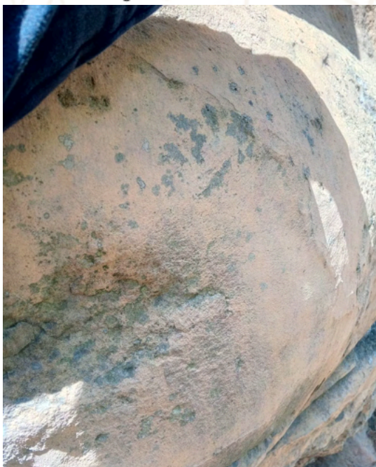
Afectación por erosión.
