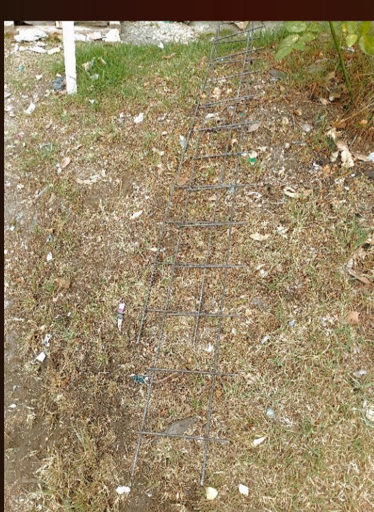
Figura 9: Fotografía del lugar donde yacía la viga de metal (2024).
