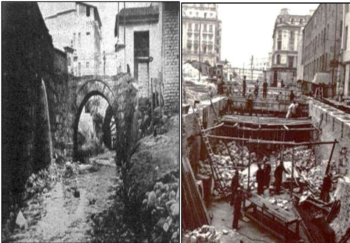
Imagen N° 37. Río San Francisco 1909. Foto tomada de http://portel.bogota.gov.co/portel/libreria/php/x_frame_detalle.php?id=32243 (Izquierda). Foto de la canalización en el centro de la ciudad, tomada de http://co.fotolog.com/bogotacity/33286715/ (Derecha)
