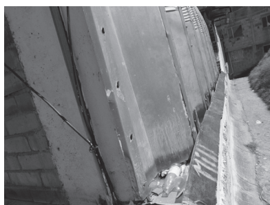
Fotografía 20. Pliegue de archidrón con basura acumulada. En algunas viviendas, la acumulación de basuras ha carcomido el metal, lo que provoca filtraciones de agua dentro de las casas que afectan la salud de los niños.
