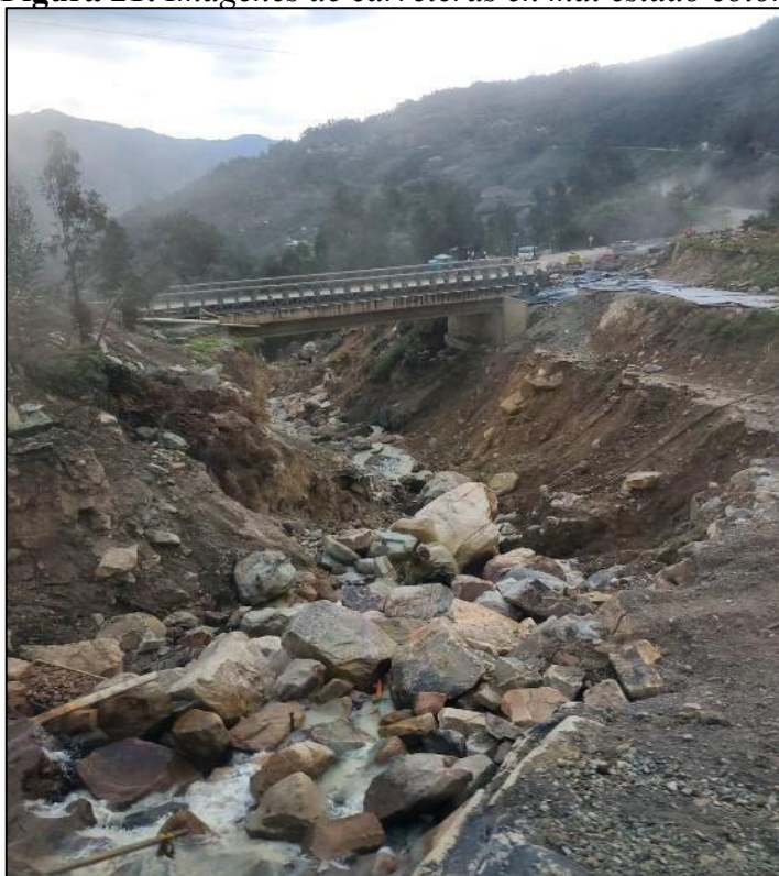
Figura 21: Imágenes de carreteras en mal estado colombianas.
